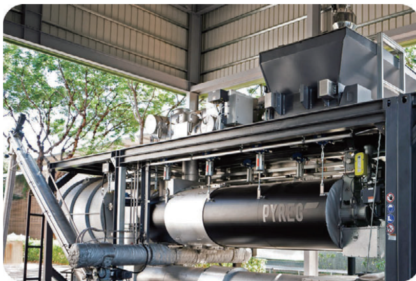
圖二、光泰環能股份有限公司之臺灣椒魚號熱裂解設備。
